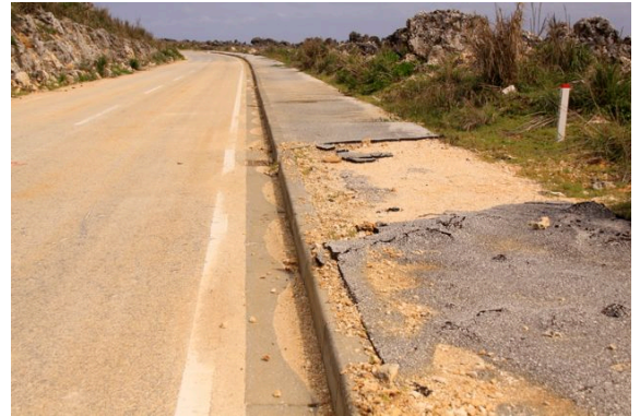
写真 4-17 台風により破壊された道路
