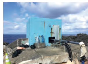
海水淡水化施設の取水施設
