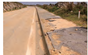
5 外周道路損壊
