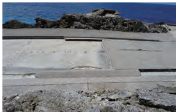
西港道路損壊
