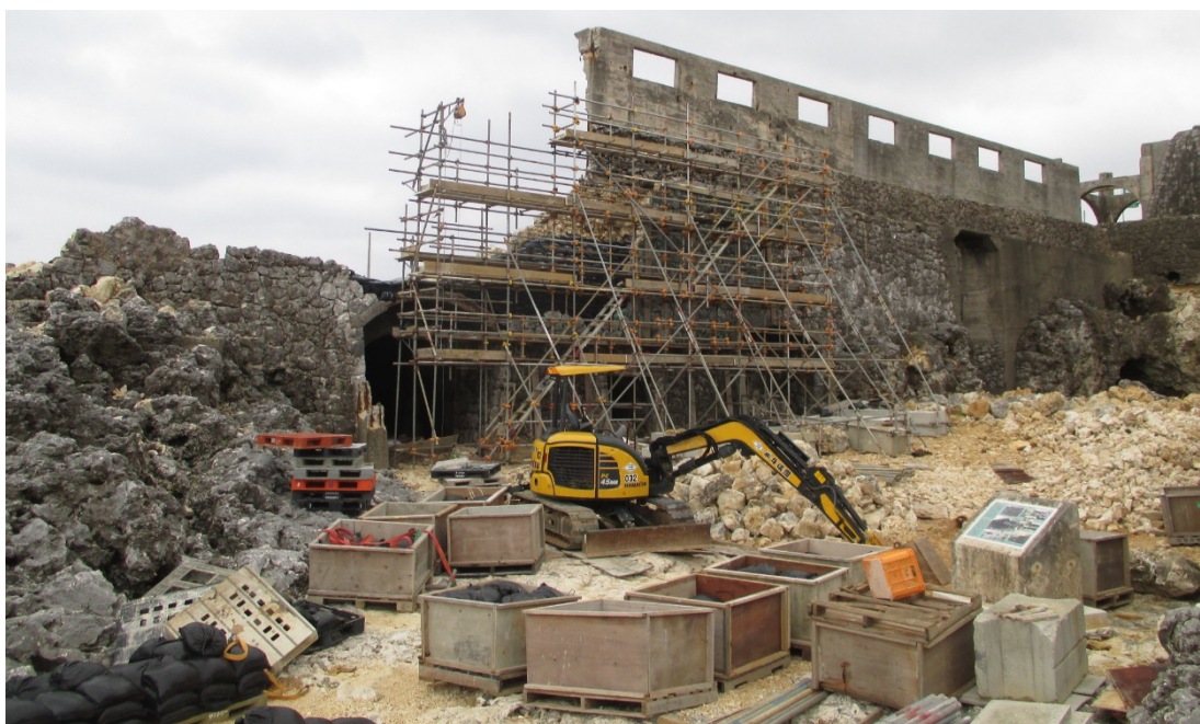
災害応急措置 (2018 年 12 月撮影)
