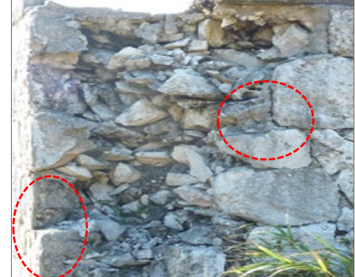
写真4の拡大 ○囲みがモルタル 写真
