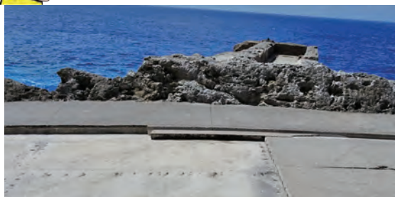
台風で路面がはがれた道路
